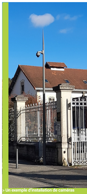
> Un exemple d'installation de caméras
