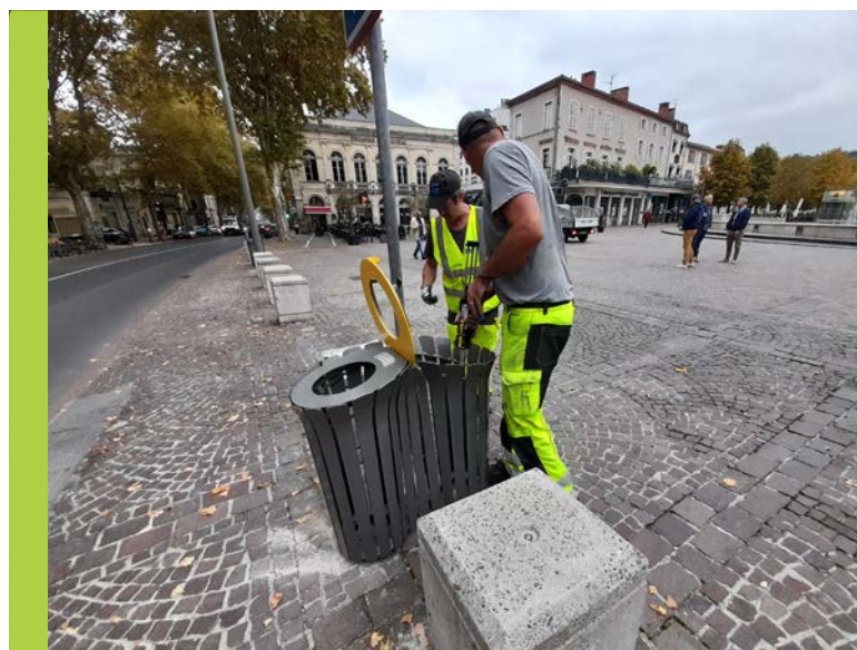
> Installation de poubelles doubles à Cahors
