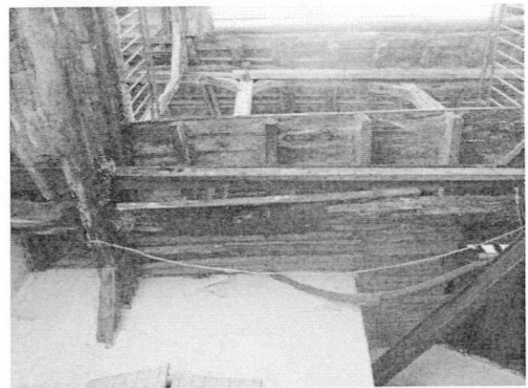
Coursives : dégradations importantes
