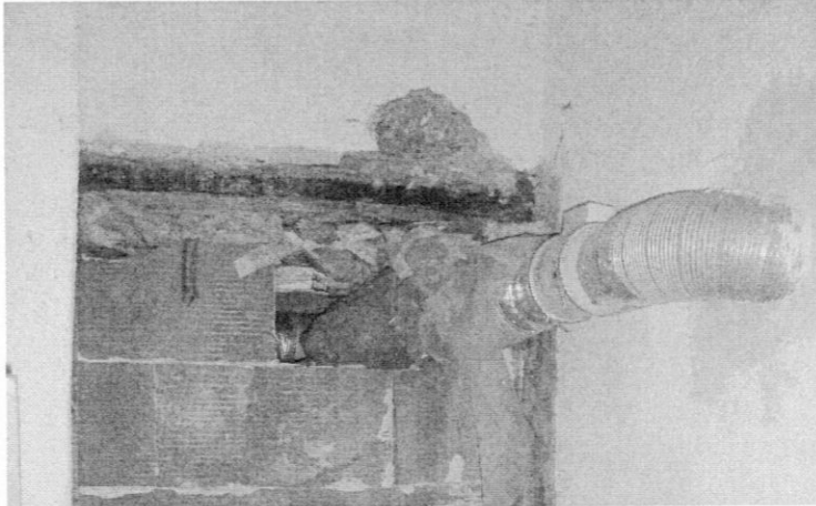
Installation anarchique VMC salle de bain, passant par l'accès privé du logement 3
