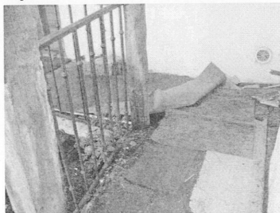
Dégradations des planchers, parties communes
