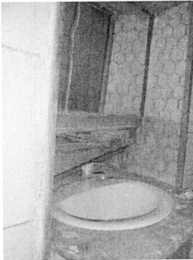
Equipements vétustes et dégradés
