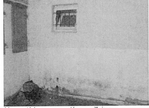
Murs extérieurs : remontées capillaires
