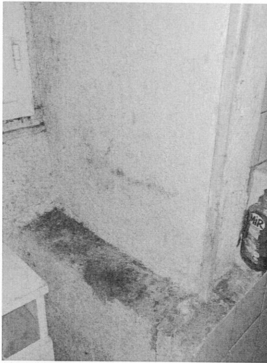
Murs cuisine : moisissures
