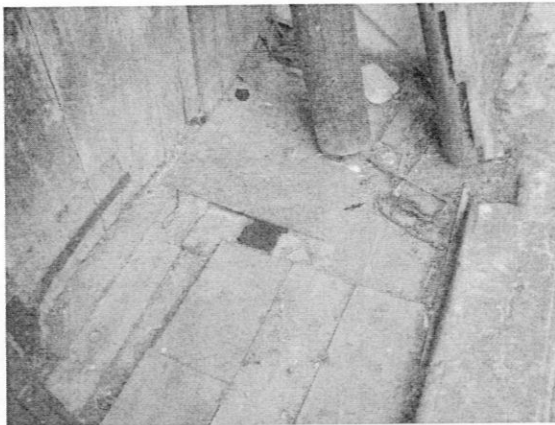
Dégradations des planchers, parties communes
