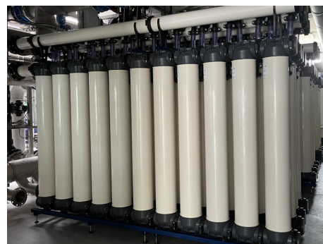
Tubes contenant les membranes de filtration
